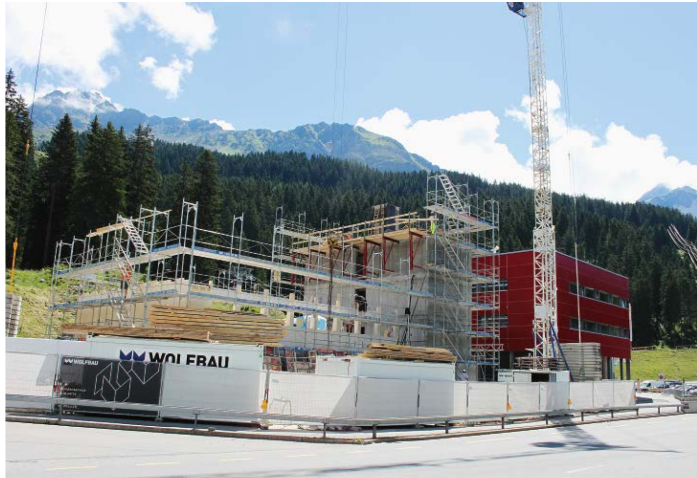
Nach der Errichtung einer «L-Form» aus Beton wurde der Leerraum mit den vorgefertigten Holzelementen ausgefacht.
