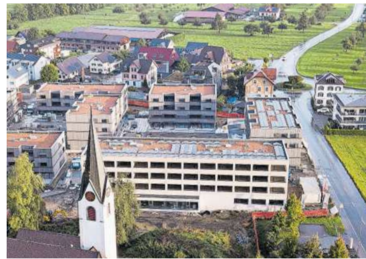
Im Erdgeschoss des Baus im Vordergrund kann die Gemeinde nun eine Gewerbefläche kaufen.
